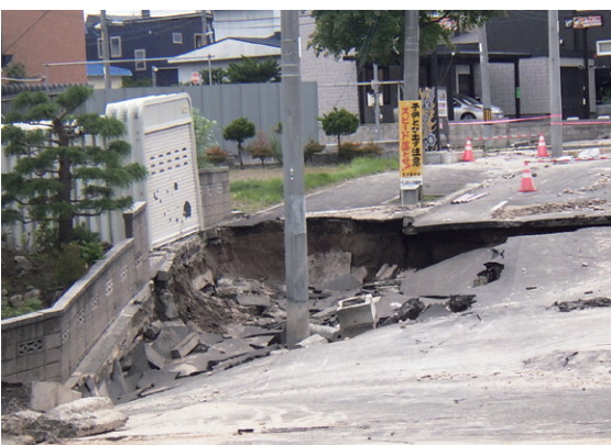
札幌市液状化現象の被害状況② (札幌市消防局提供)
